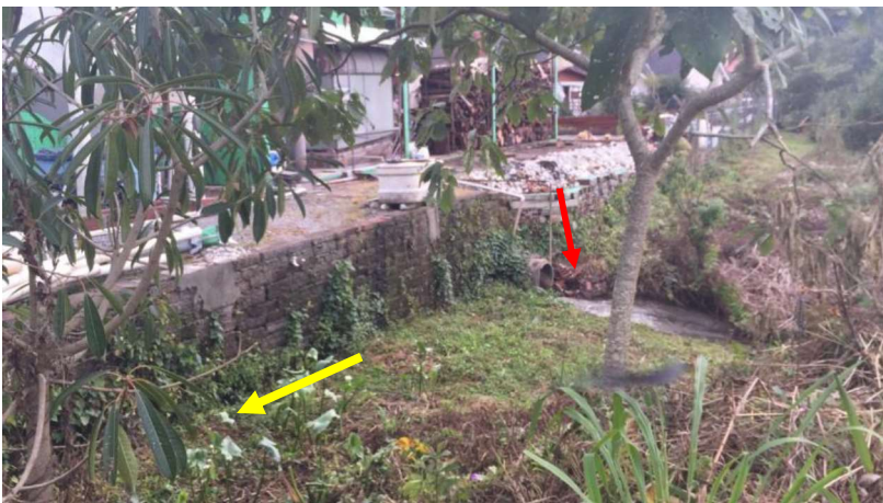
Figura 3. Drenagem lateral (seta amarela) que desagua no arroio (seta vermelha)
