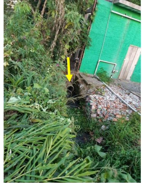
Figura 2. Drenagem lateral na divisa do empreendimento, cano (seta amarela).
