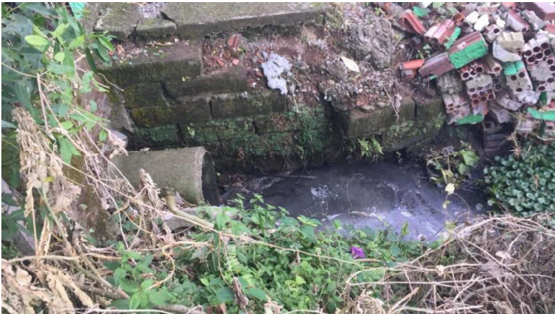
Figura 1. Drenagem lateral com aporte irregular de esgoto.
